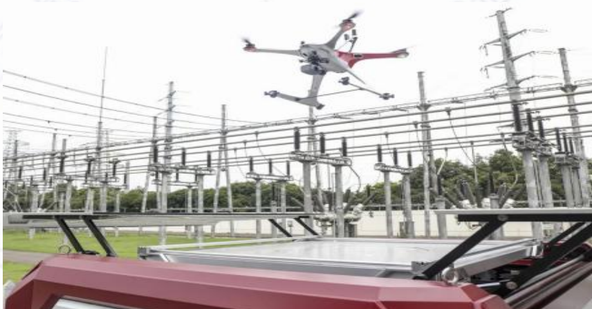
图 4-7 无人机实现电力设施智能巡检
